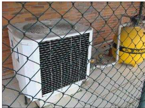
Imagem 03 – Boiler e bomba do sistema de aquecimento antigo da piscina
