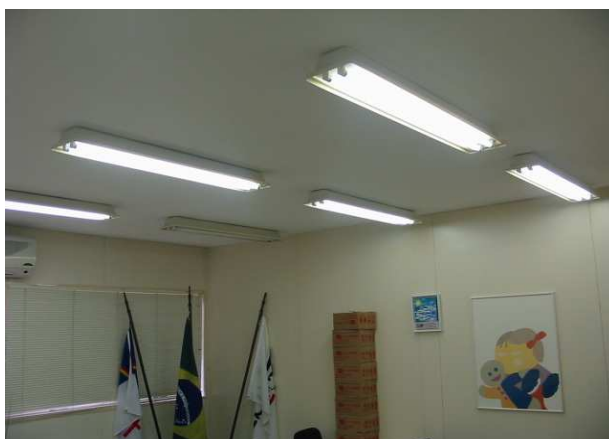
Imagem 04 – Sistema de iluminação da AACD Recife encontra-se em ótimo estado
