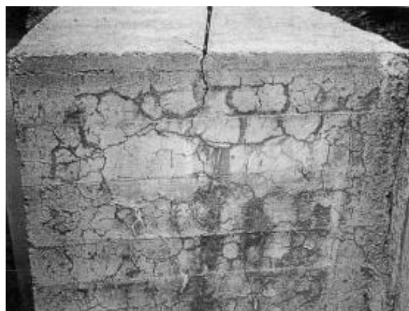
Figura 1: Bloco de concreto extraído da barragem de Graus revelando manifestações patológicas típicas do fenômeno de alteração dos sulfetos de ferro: manchas de ferrugem e fissuração superficial [6].
