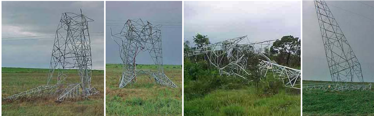
FIGURA 4: Colapso das torres números 94, 95, 96 e 108, respectivamente
