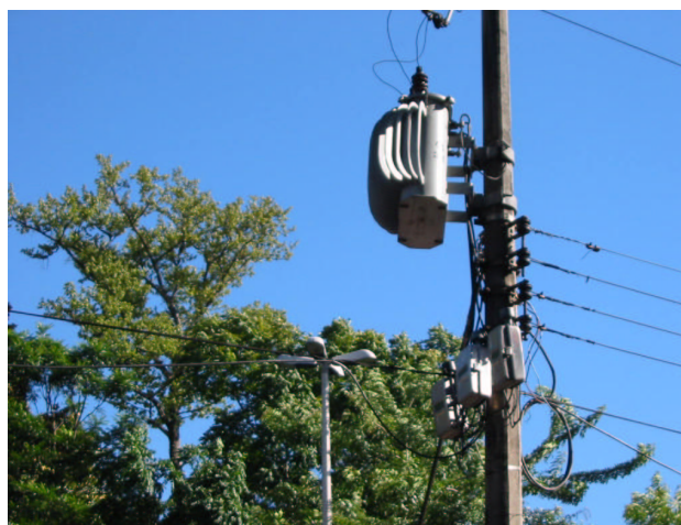
Figura 17- Foto tirada na Avenida Almirante Barroso mostrando o transformador de distribuição onde foram realizadas as medidas, e um dos postes de quatro pétalas ao fundo.
