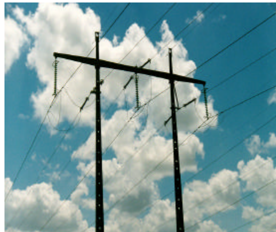
FIGURA 4 – Emprego de feixe expandido em LT existente – LT Piloto da CHESF – cabo auxiliar Linnet
