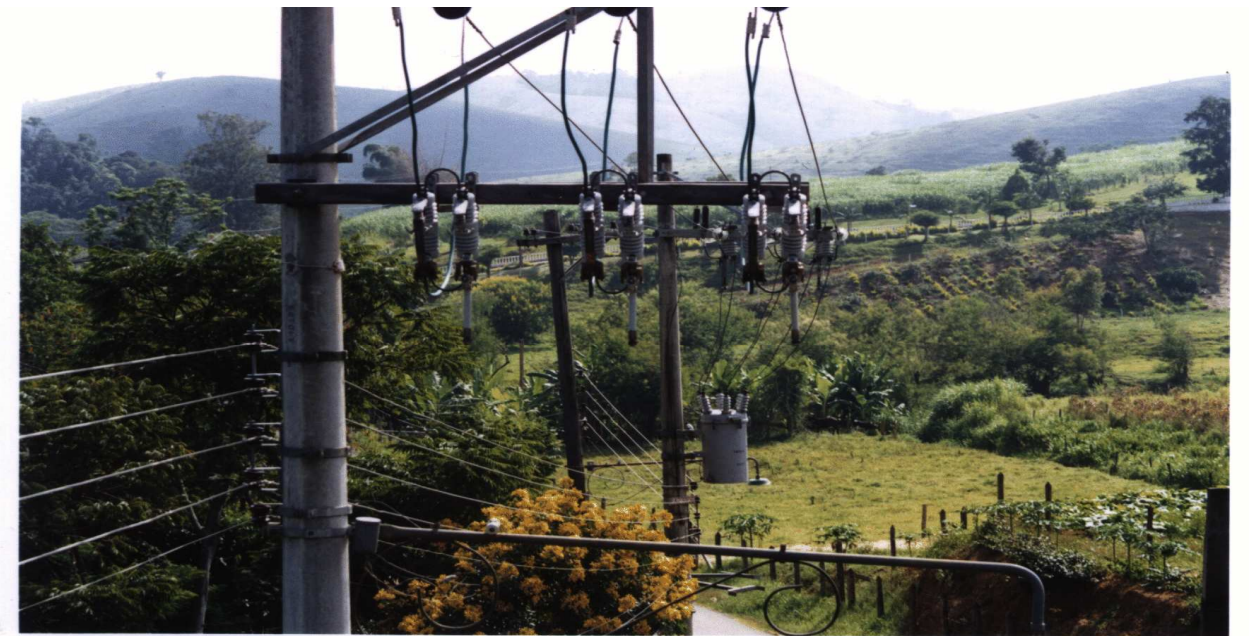
Figura II – Vista da Estrutura juntamente com a Religadora Automática.
