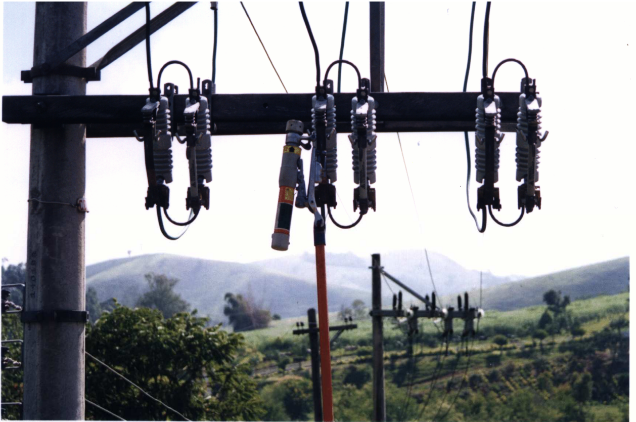
Figura I – Vista Frontal da Estrutura com as Chaves Fusível Instaladas em Paralelo.
