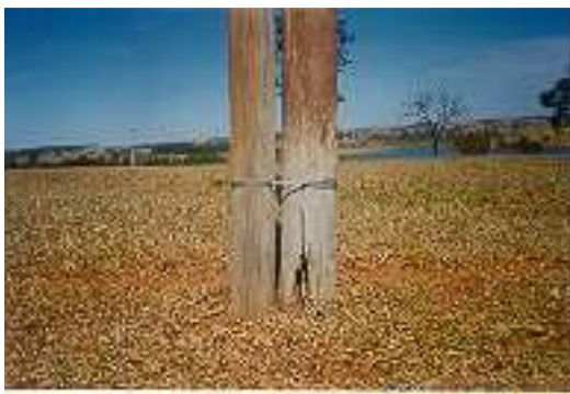
Poste atacado por cupim
