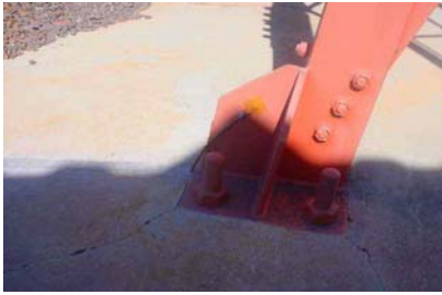
FIGURA 3 – Aterramento da torre
