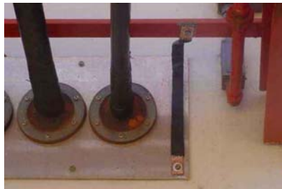
FIGURA 5 – Aterramento da placa de passagem
