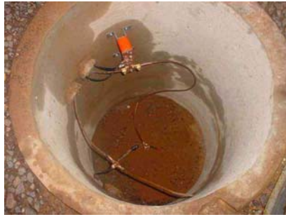
FIGURA 6 – Aterramento no poço de inspeção da alimentação AC
