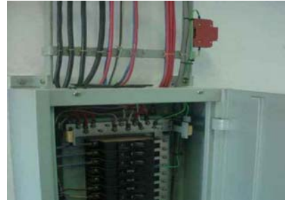
FIGURA 14 – Proteção do QDcc
