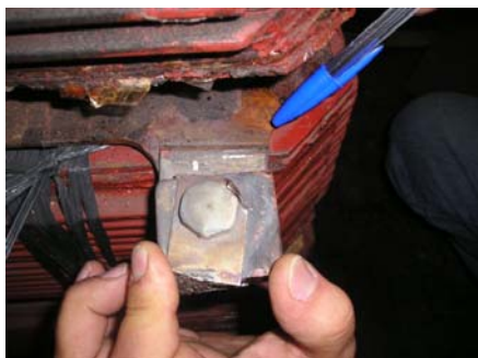
FIGURA 12 – Trinca na raiz da conexão
