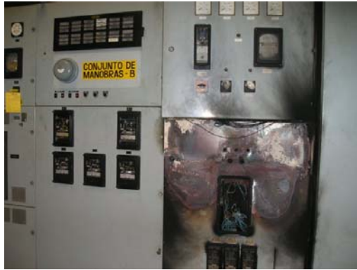
FIGURA 16 – Disjuntor do conjunto de manobras
