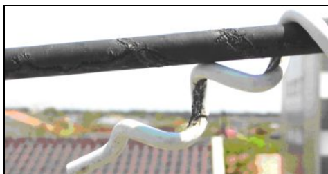
Figura 14 - Imagem do cabo e do laço de amarração a 100m apresentando trilhamento
