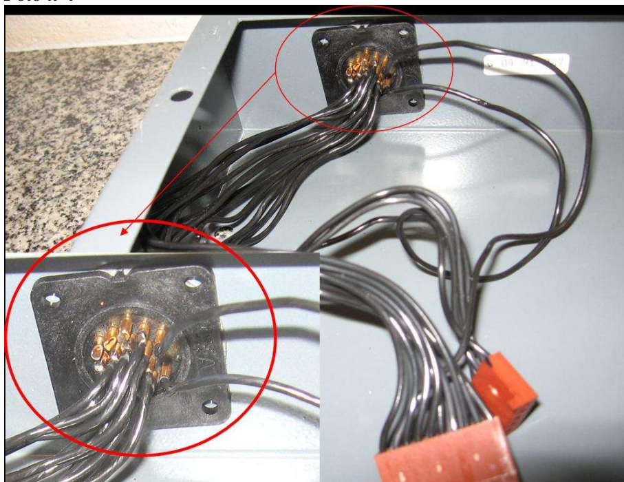
Conector de automação utilizado para alimentação externa do relé
