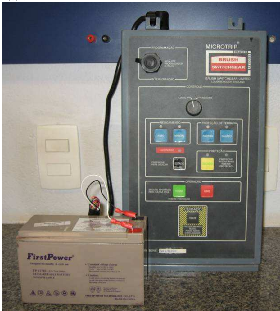
Relé Microtrip I adaptado, com alimentação por bateria externa
