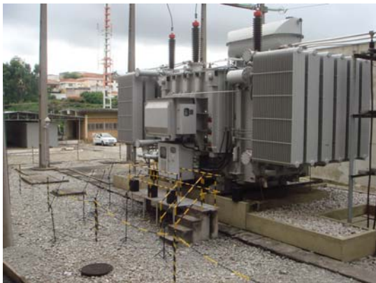
Fig. 11: Transformador com o ANC
