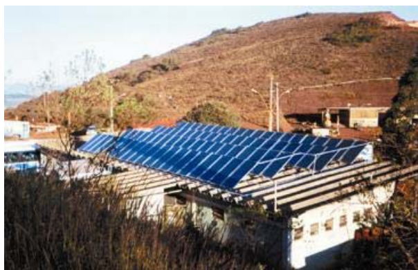
FIGURA 2- Mineração Mannesmann & Vallourec Belo Horizonte/MG Vestiários e Restaurante Projeto desenvolvido pela CEMIG e Agência Energia.
