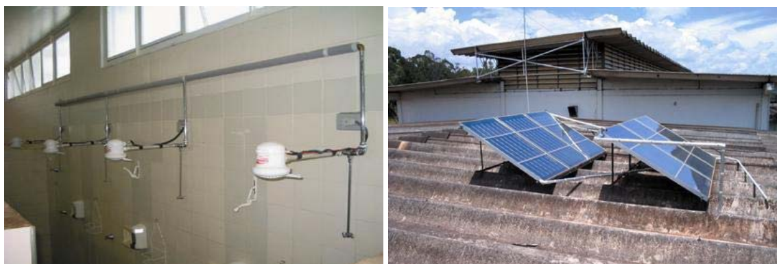
FIGURA 1 - Granja Planalto - Uberlândia/MG Vestiários Projeto desenvolvido pela Efficientia e Agência Energia 180,40 kW de demanda deslocada do horário de ponta.
