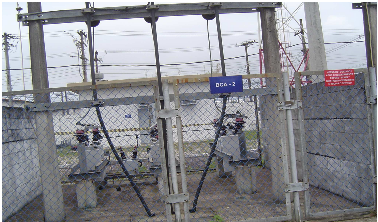
Figura 1 – Banco de Capacitores de 2,4 MVAR instalado na SE Praia Grande
