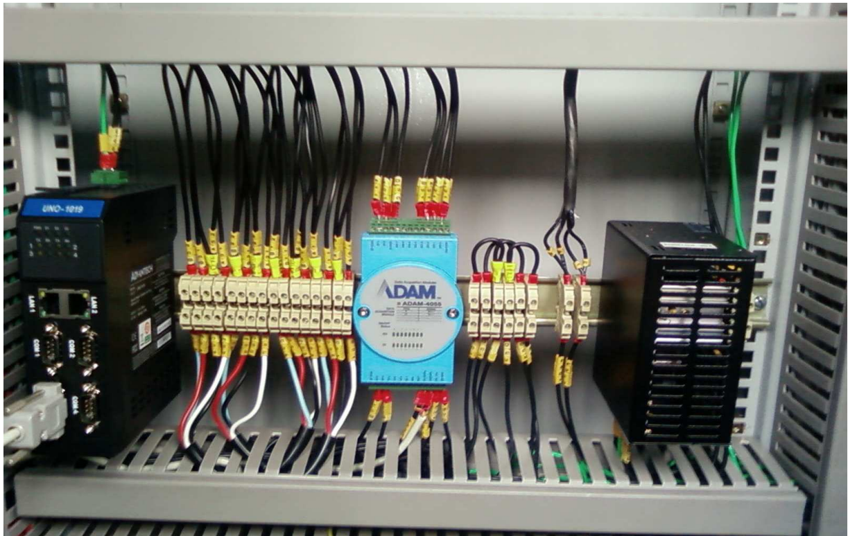
Figura 6 – Montagem do sistema de controle na UTR
