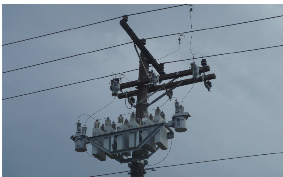
Figura 4 – BCDS-1F de 1,2 MVAR Instalado
