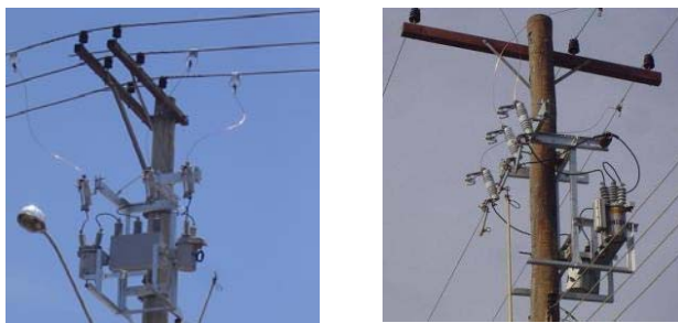
Figura 2: Instalação do Banco em Campinas
