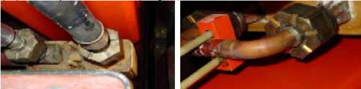
FIGURA 1 - Conexão hidráulica dos circuitos de refrigeração
