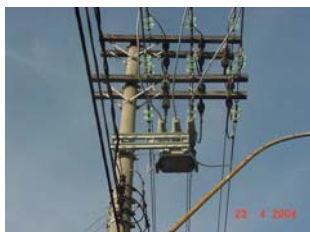
Figura 4 – Conjunto de Medição em Média tensão
