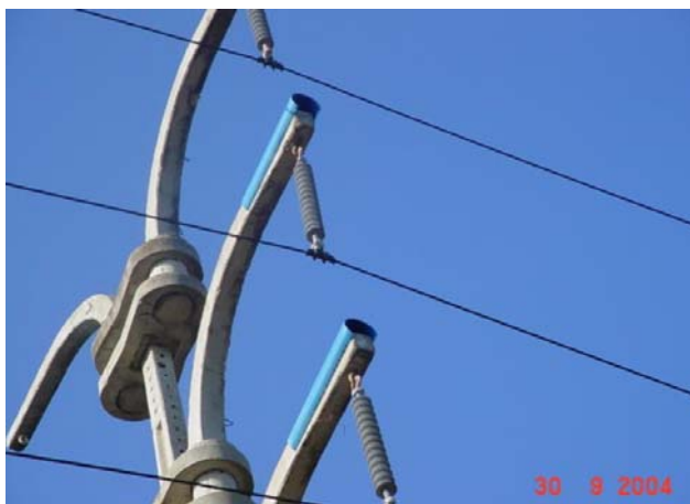
Figura 5 – Visão geral das proteções instaladas em uma estrutura.
