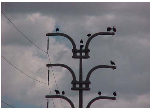
Figura 2 – Situação dos Urubus nas estruturas de 69 kV.
