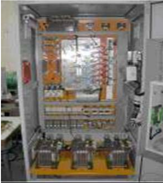
Figura 7. MDVR-1/3 – Vista frontal (Inversor, Banco de capacitores, Transformadores de Injeção, Filtro de saída e Proteções)
