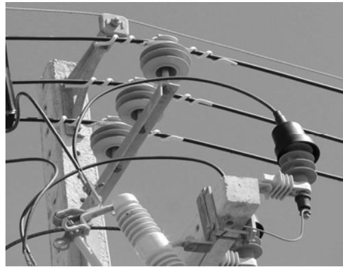
Figura 1: Isoladores poliméricos utilizados em linhas aéreas de distribuição de energia elétrica.
