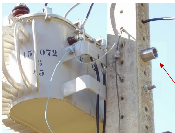
Figura 4 - Transformador com Dispositivo Anti-Furto
