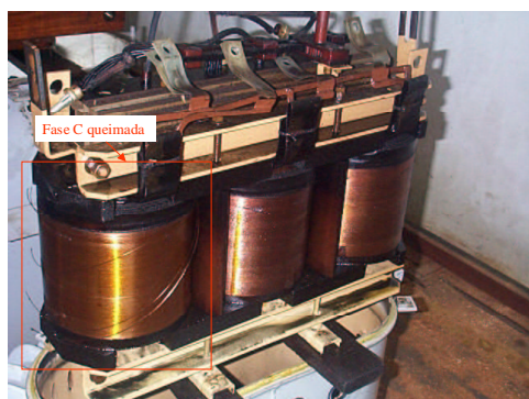
Figura 2 – Transformador com a fase C queimada por sobrecarga
