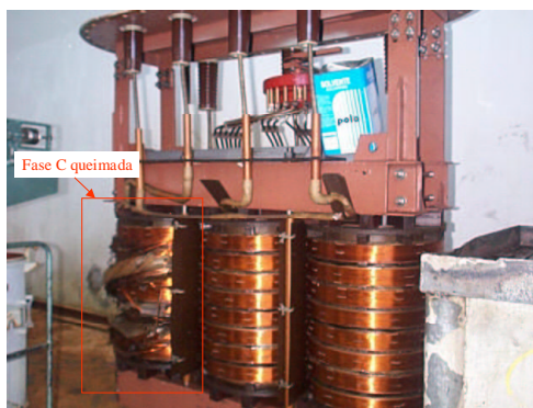
Figura 1 – Transformador com a fase C queimada por sobrecarga
