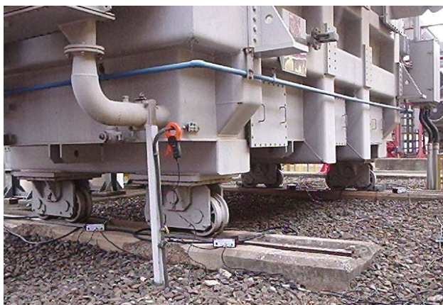
Figura 10. Medição das correntes nas rodas e no cabo de terra do transformador.
