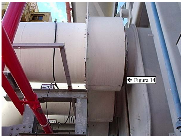
Figura 14 – Ponto de Conexão dos condutores de BT com o transformador.
