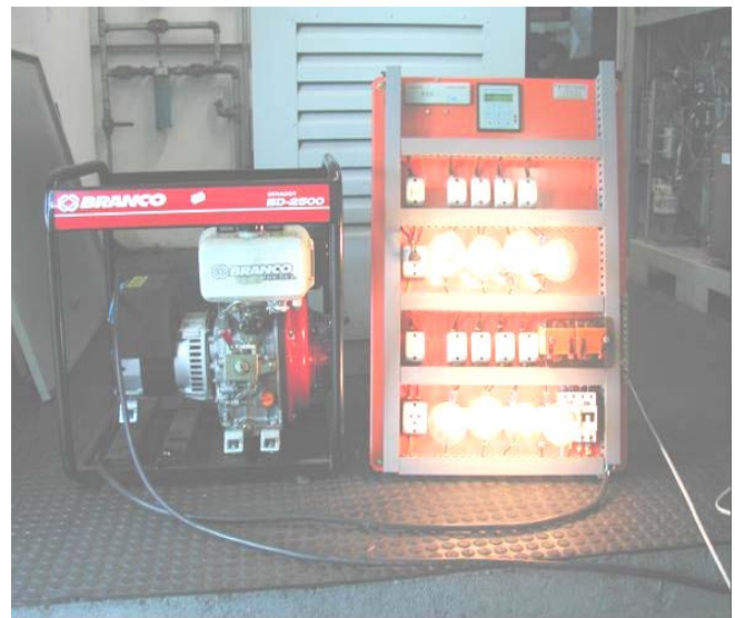
Figura 5 – Grupo Motor-Gerador e quadro de carga (em funcionamento)
