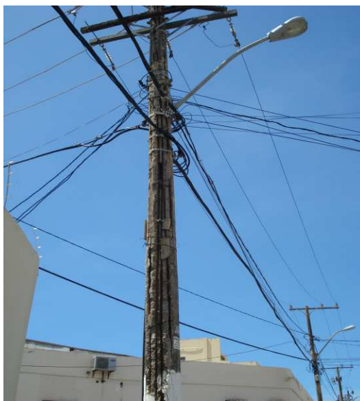
FIG. 6 – POSTE DE CONCRETO, EFEITO AÇÃO SALITROSA.
