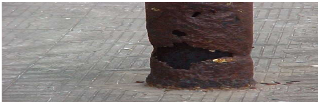
FIG. 8 – POSTE TUBULAR DE AÇO COM CORROSÃO EM SUA BASE
