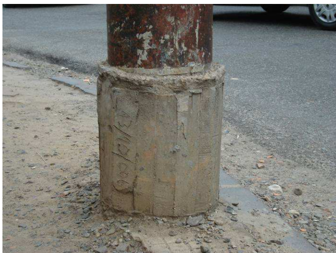
FIG. 10 – POSTE TUBULAR DE AÇO COM BASE RECUPERADA E COBERTO COM CONCRETO
