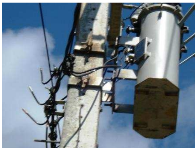
FIG. 11 – TRANSFORMADOR SOLDADO NA TAMPA E CINTAS SOLDADO
