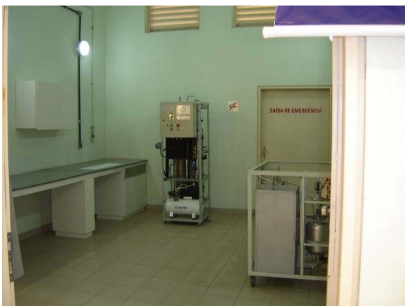
Figura 15: Reformador de etanol e sua coluna de purificação – Laboratório de Hidrogênio.
