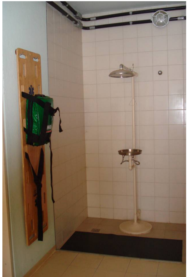
Figura 10 – Chuveiro de emergência e lava-olhos.
