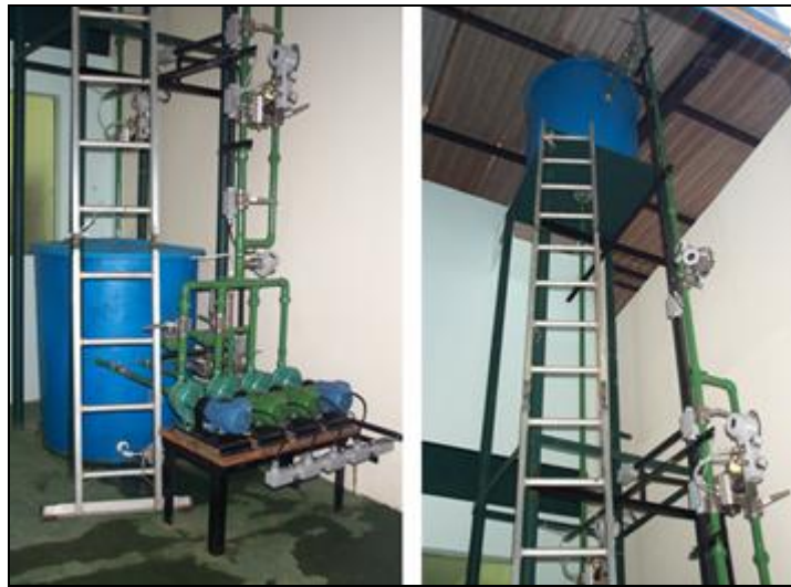
FIGURA 9 – Bancada de Bombas / UFBA
