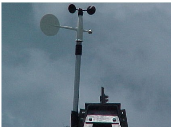
FIGURA 5 – Sensores de anemógrafo sobre a torre
