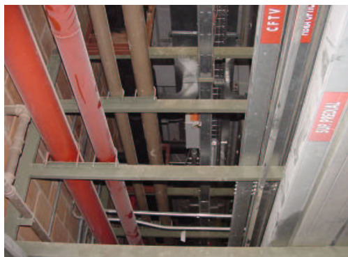
FIGURA VI VISTA DE BAIXO DA INFRA INSTALADA NOS CORREDORES TÉCNICOS, NO CENTRO ENCONTRA-SE O BARRAMENTO BLINDADO DE BAIXA TENSÃO
