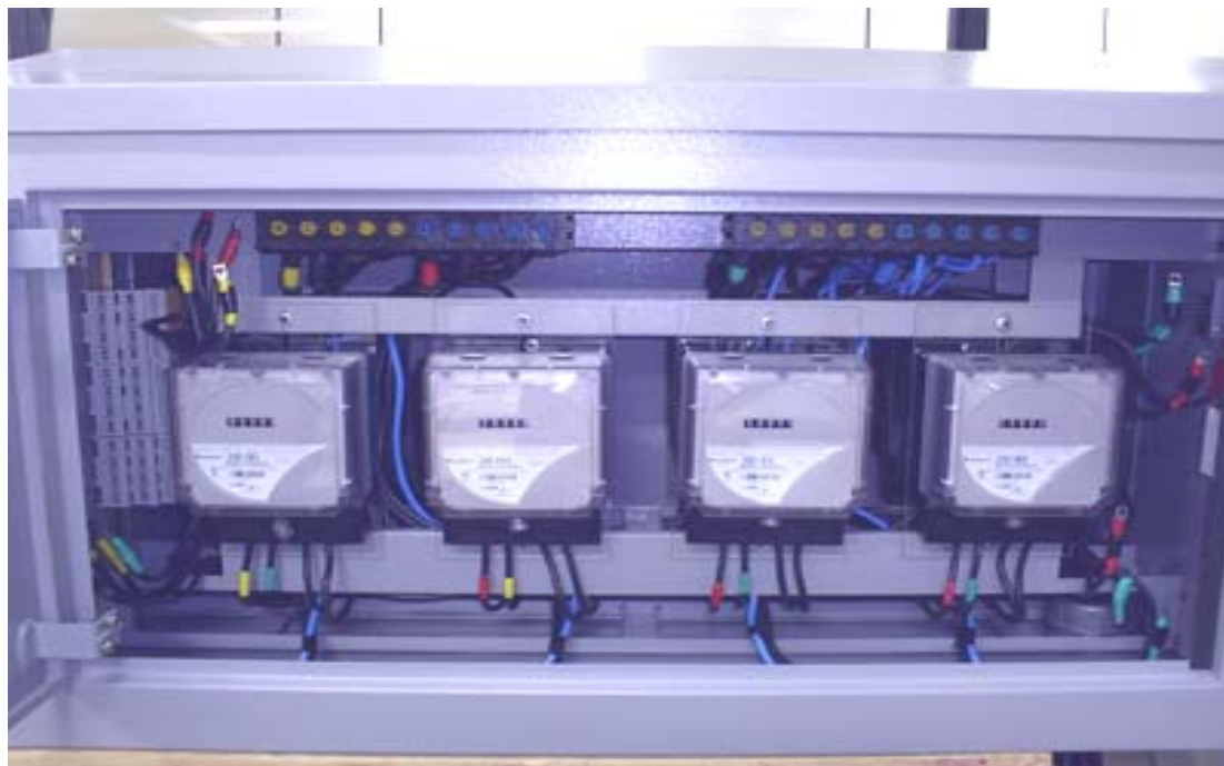
Figura 1 – Vista interna da Caixa de Medição Concentrada
