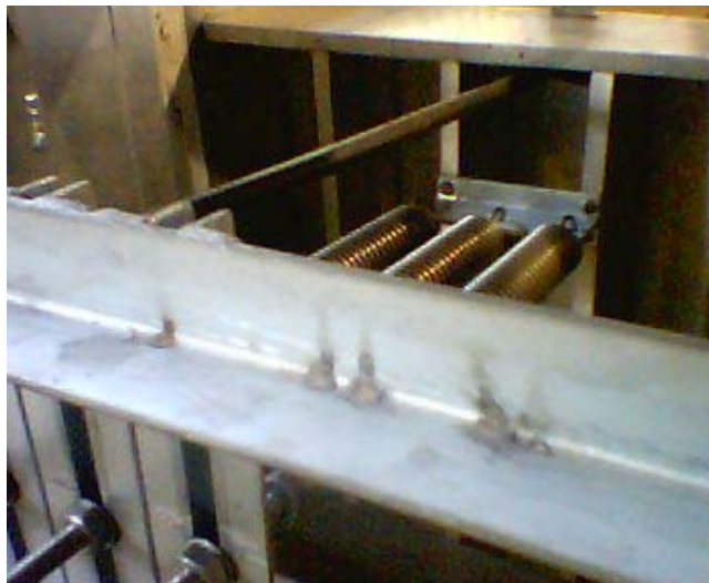
Figura 4: Aspecto da fixação elástica da comporta montada com molas de tração e barra de compressão, em vista de jusante
