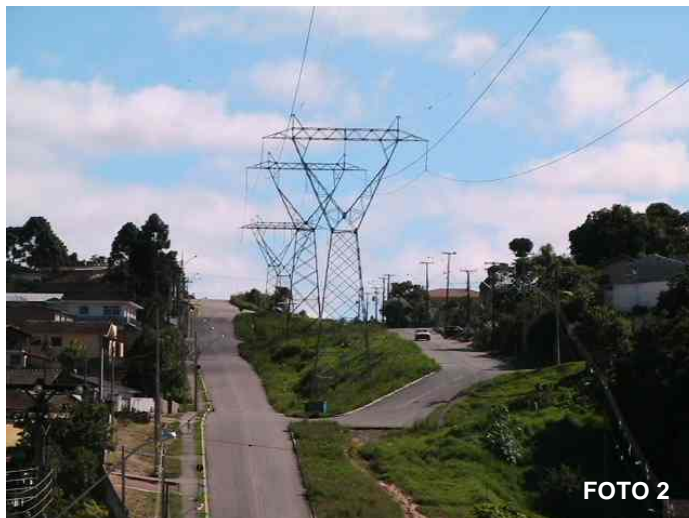
FIGURA 5: trecho da linha de transmissão recapacitada
