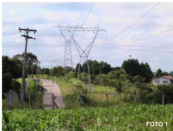
FIGURA 4: trecho da linha de transmissão recapacitada
