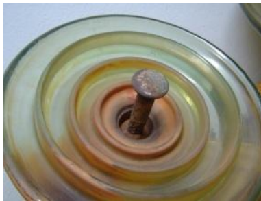
FIGURA 4 – Isolador de vidro descartado pela corrosão existente no pino
