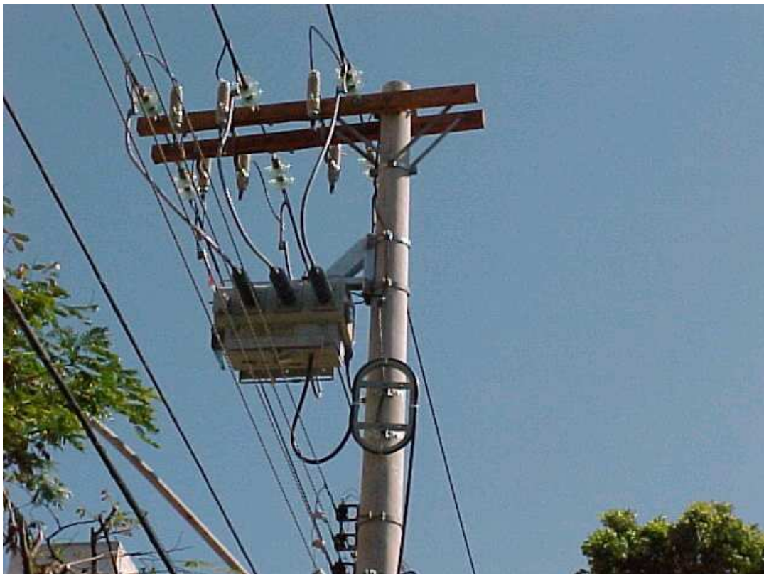
Figura 5 – Chave Seccionadora Automatizada Instalada.
