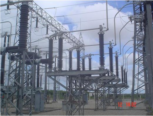
Figura 14. Conjunto de chaves do tipo EV – 2000 na rede 230kV.
