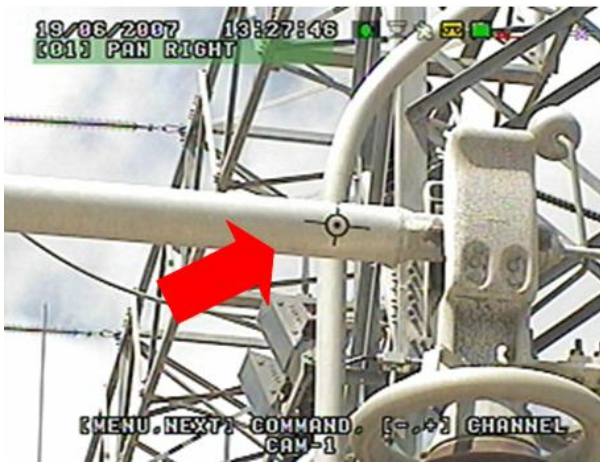
Figura 9. Detalhe do adesivo (marcação) sobre o contato móvel.
