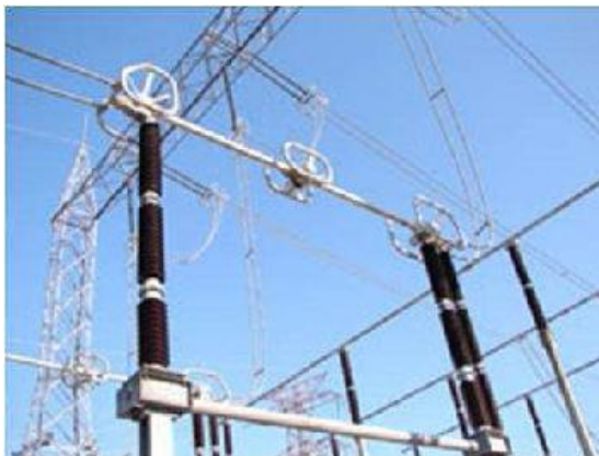
Figura 2. Chave seccionadora de 500 kV, do tipo semi-pantográfica.
