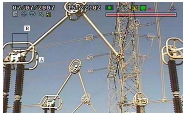
Figura 8. Detalhes da chave seccionadora: região (A) e região (B).
