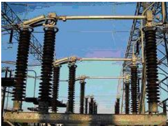
Figura 1. Chave seccionadora de 230 kV, do tipo EV-2000.
