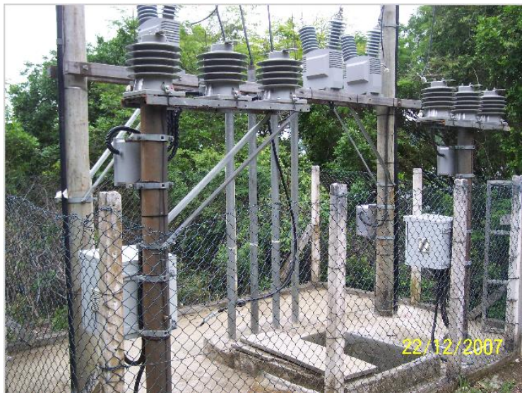
Imagem 2 – Barramento adaptado com os TP's, TC's e painel instalados.
