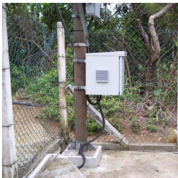
Imagem 3 – Painel onde foram instalados o relé e o modem GPRS..
