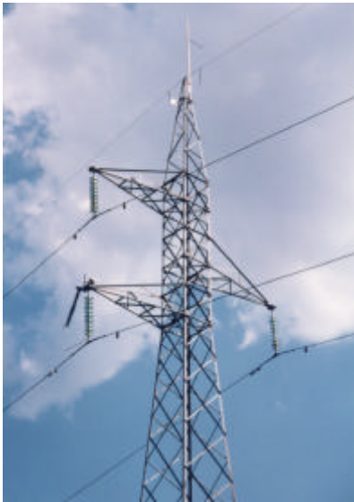
Figura 7: PÁRA-RAIOS COMPOSTO EM LINHA DE 138 KV NO BRASIL
