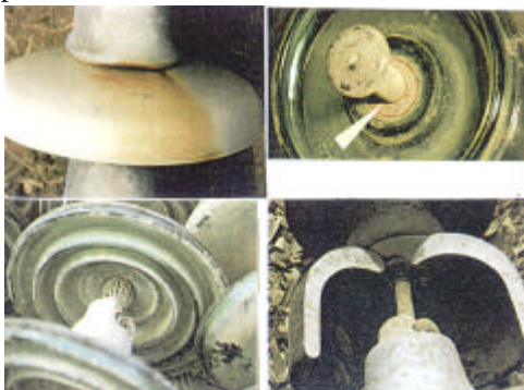
Figura 1: DANOS TÍPICOS DA CORROSAO EM ISOLADORES
