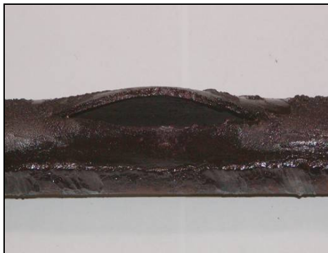
Figura 1 - Tubo parede falhado
