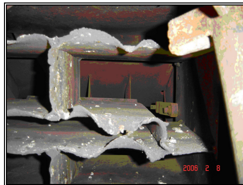
Figura 2- Direcionador de ar deteriorado
