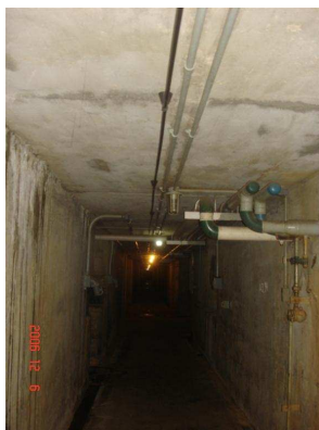
Figura 2 – Cabo coaxial irradiante passando no teto da galeria em Itumbiara
