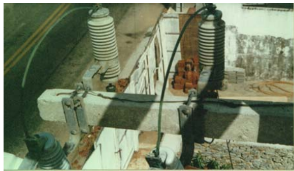
Figura 8 - Foto das chaves A e B no transformador do N.H.
