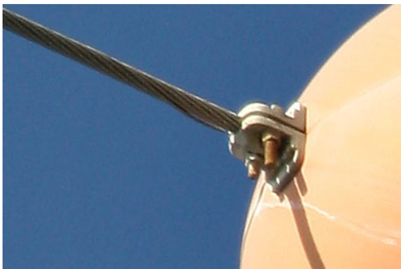
FIGURA 5 – Tento Partido do Cabo Pára-Raio da 2ª Esfera de Sinalização da LT Rio Largo – Braskem, 230 kV, Lado FONTE.
