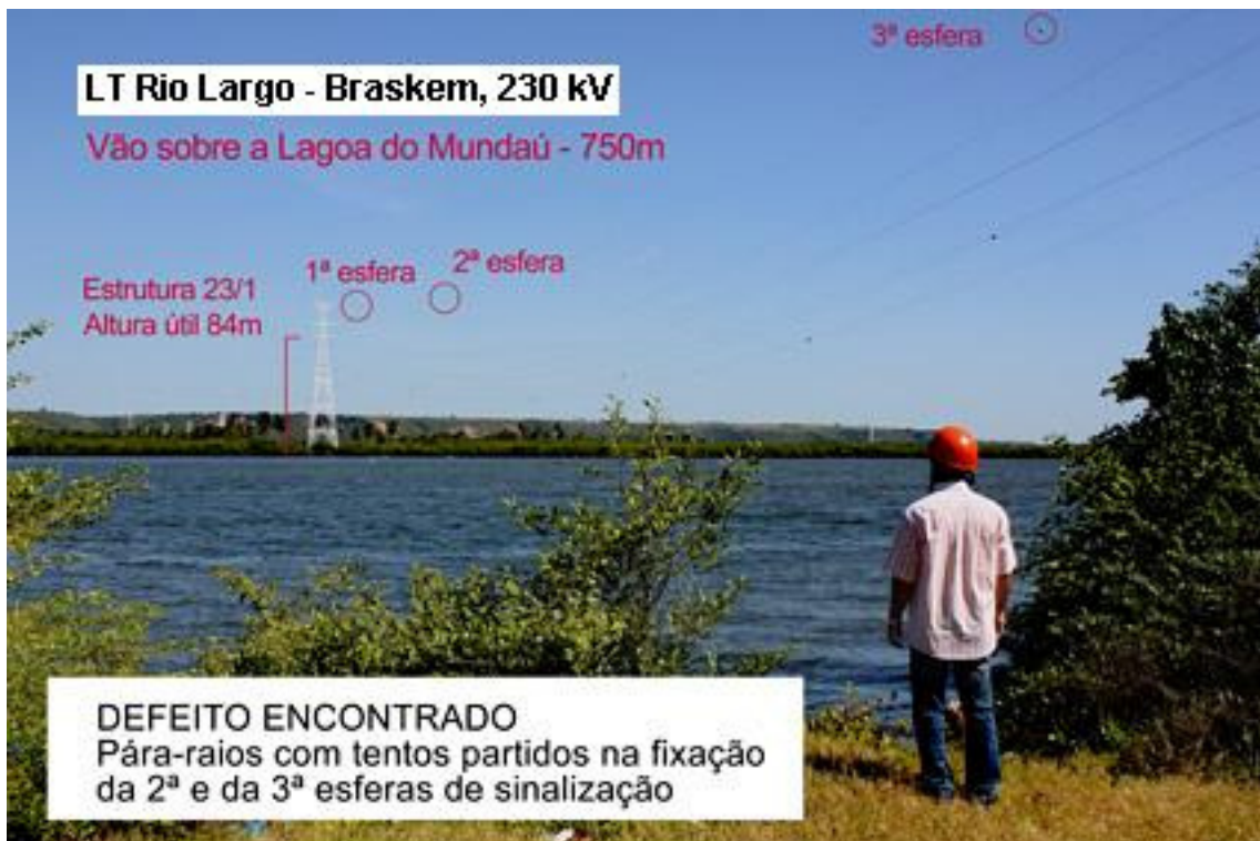
FIGURA 3 – Vão da Estrutura 23/1 da LT Rio Largo – Braskem, 230 kV.
