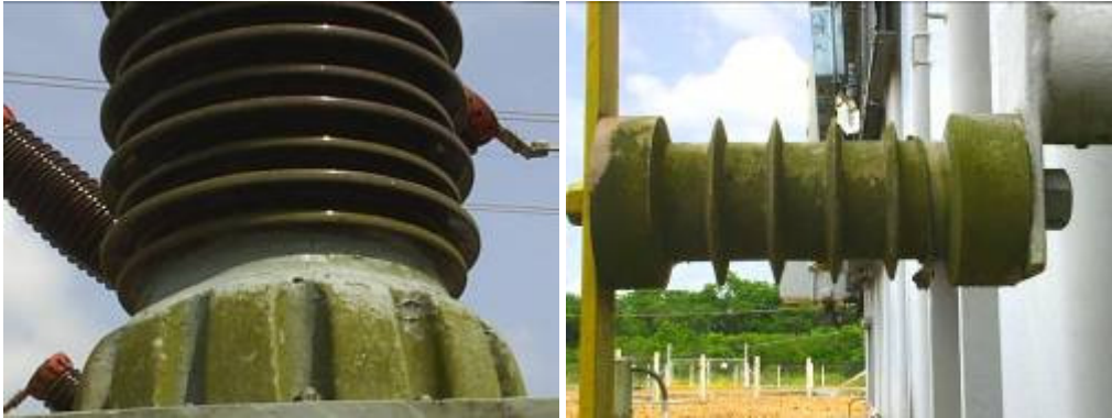
FIGURA 1 – Equipamento contaminados com limo em subestações da ELETRONORTE
