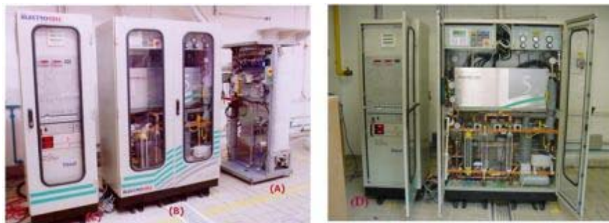
FIGURA 1 – Sistema de célula a combustível de membrana polimérica trocadora de prótons do Laboratório de Células a Combustível do CEPEL: (A) reformador de GN; (B) unidade PEMFC – 5 kW; (C) sistema de eletrônica de potência (inversor CC/CA) e banco de baterias; (D) detalhes dos gabinetes abertos.
