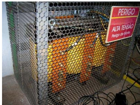
(b) Transformador 45kVA 220/380V
