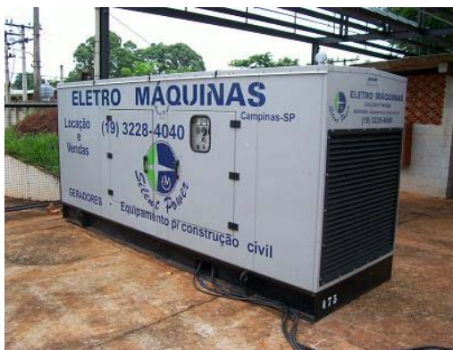
(a) Grupo Motor-Gerador Diesel 150kVA – 220V
