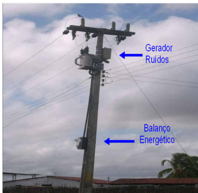
Imagem 2: Gerador de ruídos instalado no secundário do transformador
