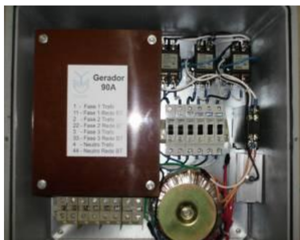
Imagem 1: Gerador de ruído Trifásico
