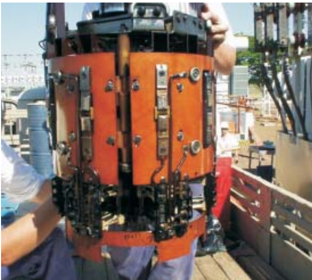
FIGURA 2. Vista dos contatos externos do comutador do TR1 da SE Andradina
