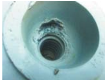
FIGURA 6 - Danos nos isoladores de pino após 12 meses no campo.
