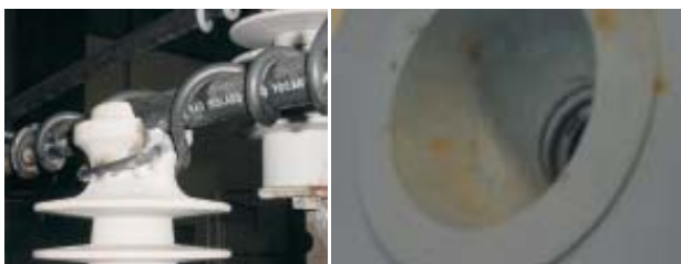
(a) - Isolador de pino 1 (b) - Isoladores de pino 2 a 5
