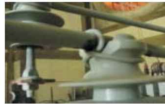
FIGURA 17. Dano na interface isolador-cabo em amostra do isolador de pino 2 após ensaio de compatibilidade dielétrica com cabo 3.
