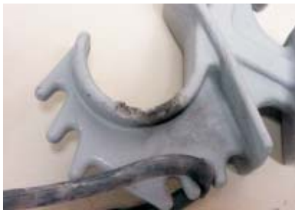
FIGURA 2 - Danos no espaçador 2 após 4 meses no campo.
