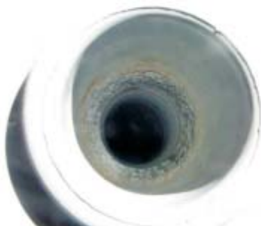
FIGURA 5 - Danos internos nos isoladores de pino após 8 meses no campo.
