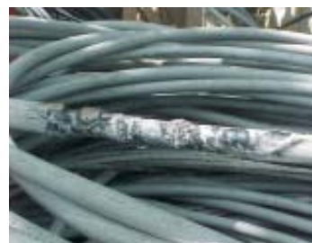
FIGURA 7 - Danos nos cabos após 12 meses no campo.
