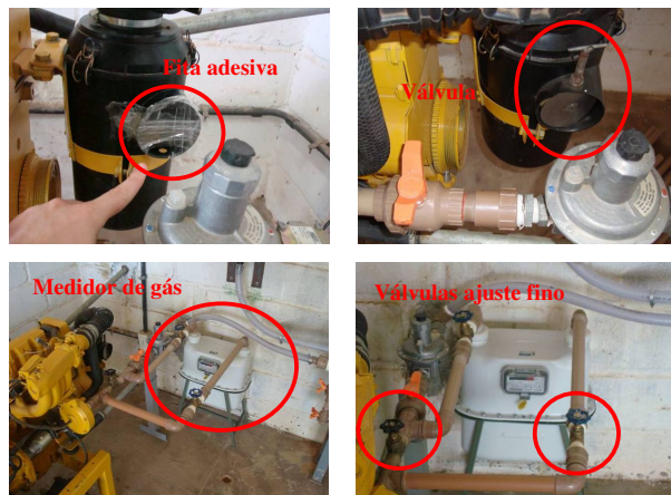
Figura 7. Ilustração das intervenções no gerador para melhoria da eficiência elétrica.
