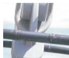
(a) Ponto de Amarração do Cabo ao Espaçador com Anel Apresentando Acúmulo de Sal e Início de Trilhamento.
