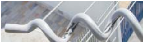
(b) Laço de Amarração Apresentando Trilhamento Elétrico nas Regiões de Contato com o Cabo.
