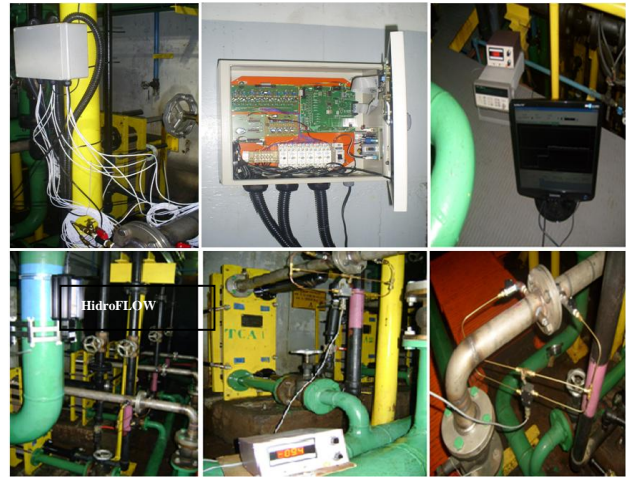
Figura 3. Detalhes do sistema de medição instalado na Usina).
