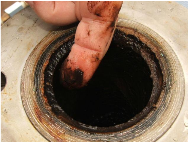
Figura 5. Incrustações nos dutos do circuito de água de refrigeração
